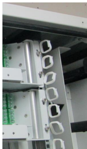
Figure 17. Anneau de guidage sur les montants 19 pouces de l'armoire RTO
